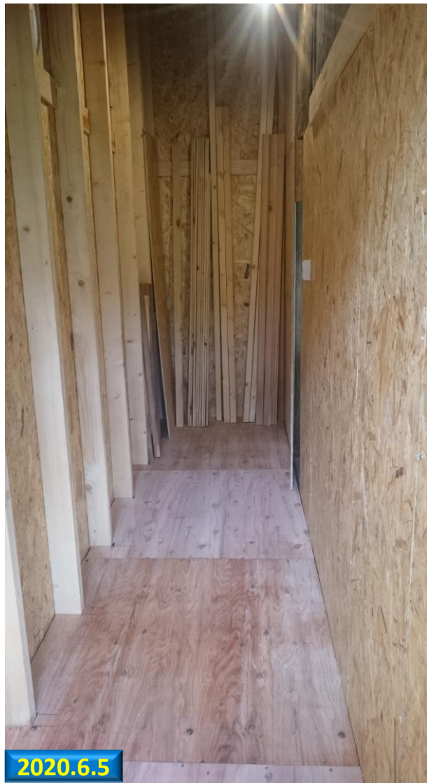
内部 床を葺き, 長尺物をしまい始めた. コンセント1個, 電灯2個増設した.
